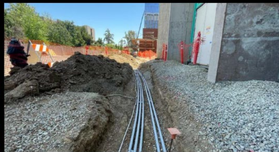
Site Lighting Conduit LSTE-E
